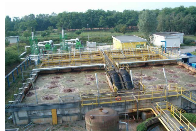
Impianto di depurazione/cogenerazione
